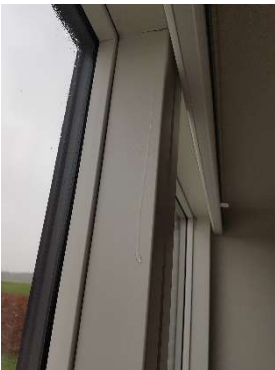
Vandskade på alle vinduer
