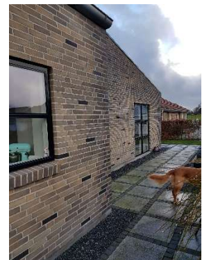
Vand i murværk
